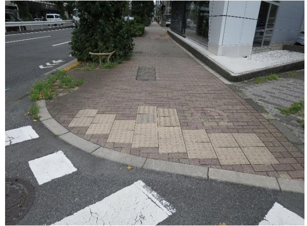
交差点の歩道入口の段差 点字ブロック
