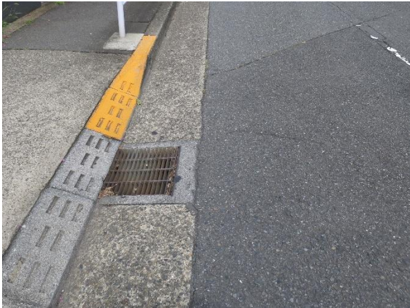
車道脇の傾斜している側溝 排水溝
