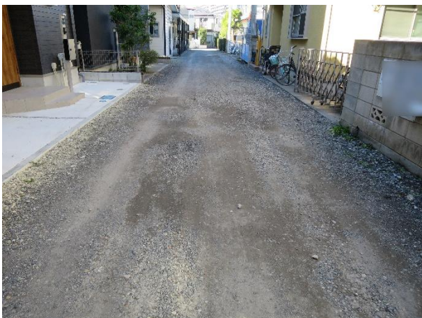
写真 33 舗装されていない道路
