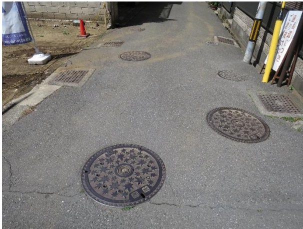
写真 30 マンホールの表面が道路面より上に膨らんでいる
