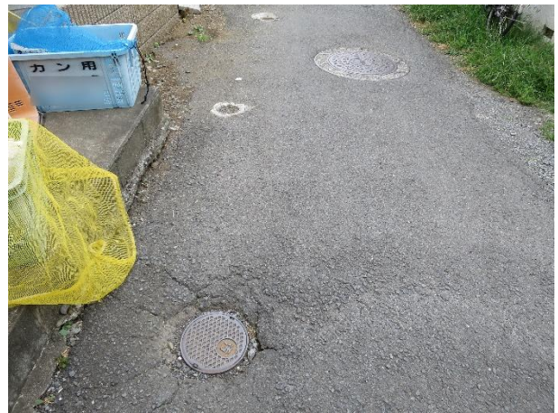
写真 31 メーターボックスと道路の間が窪んでいる
