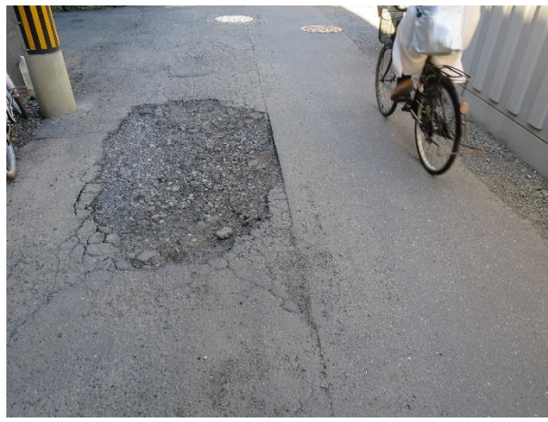
写真 35 路面が亀裂している箇所を避けて通行する自転車
