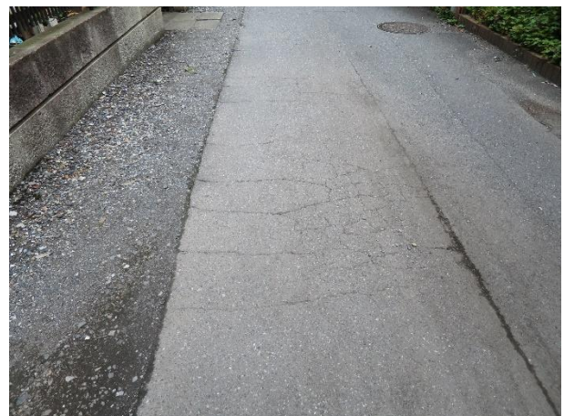
写真 34 道路の一部が舗装されず小石が散乱している
