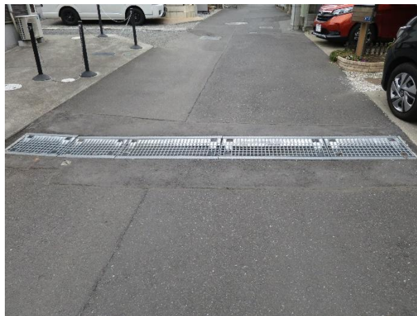
写真 32 排水溝のスリット幅が広くタイヤが間に挟まれる危険性
