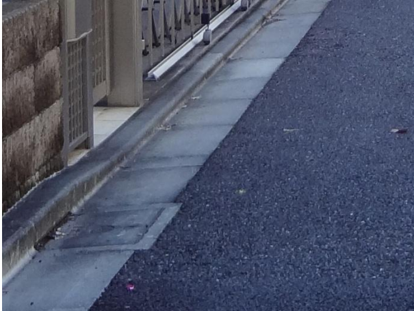
写真 26 路面が異なる道路と側溝・側溝が傾斜
