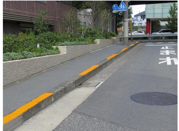
写真 28 歩道と車道の路面の高さが異なる段差
